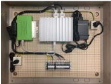
通信用モジュール / 制御PC
