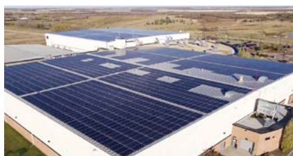
カナダ 設置容量:1.14MW
