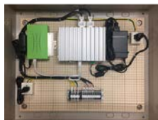
通信用モジュール / 制御 PC
