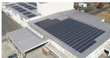
茨城県 設置容量:298.20kW
