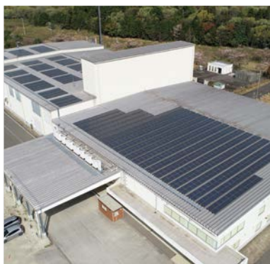
茨城県 設置容量:298.20kW
