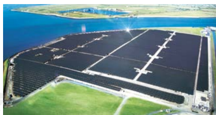
福岡県 設置容量:22.9MW
